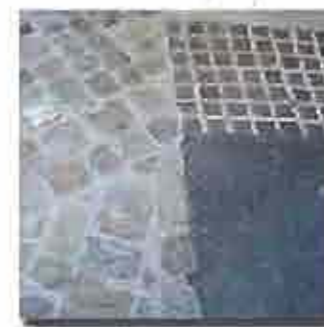
intersezione tra le due pavimentazioni in porfido e l'asfalto (D)
